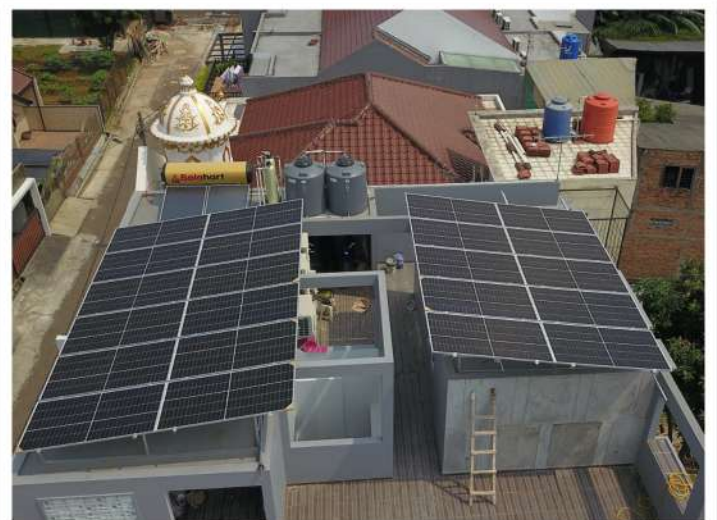
@ Bekasi - 15 kW On Grid
